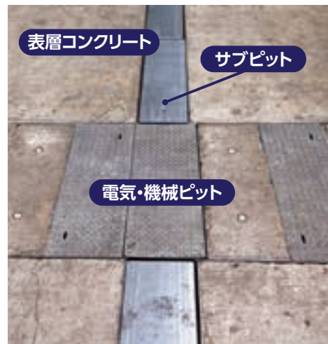
電気・機械ピットとサブピット
