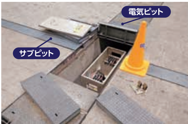
ピット(電気ピット)とサブピットの内部
