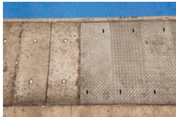
電気・機械ピット蓋
